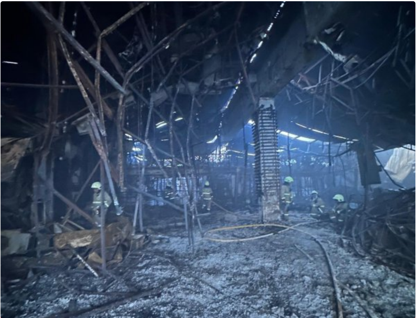
Glodok Plaza yang Hangus Terbakar
